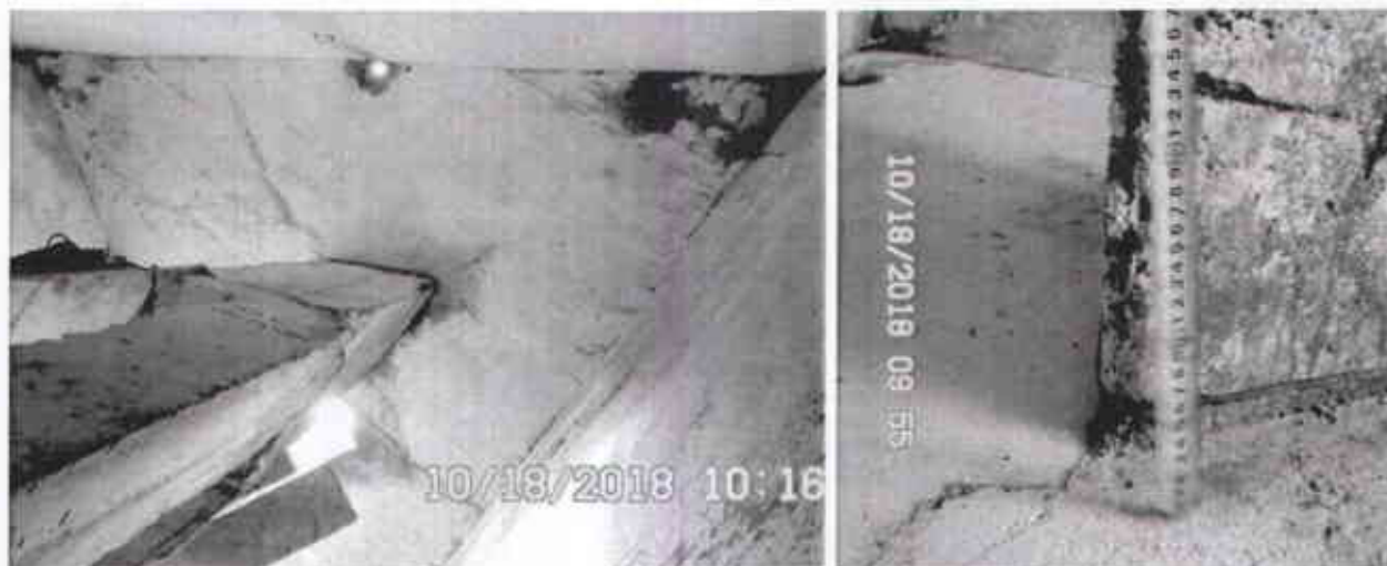
Hình 4.14 – Khảo sát vết nứt sàn
