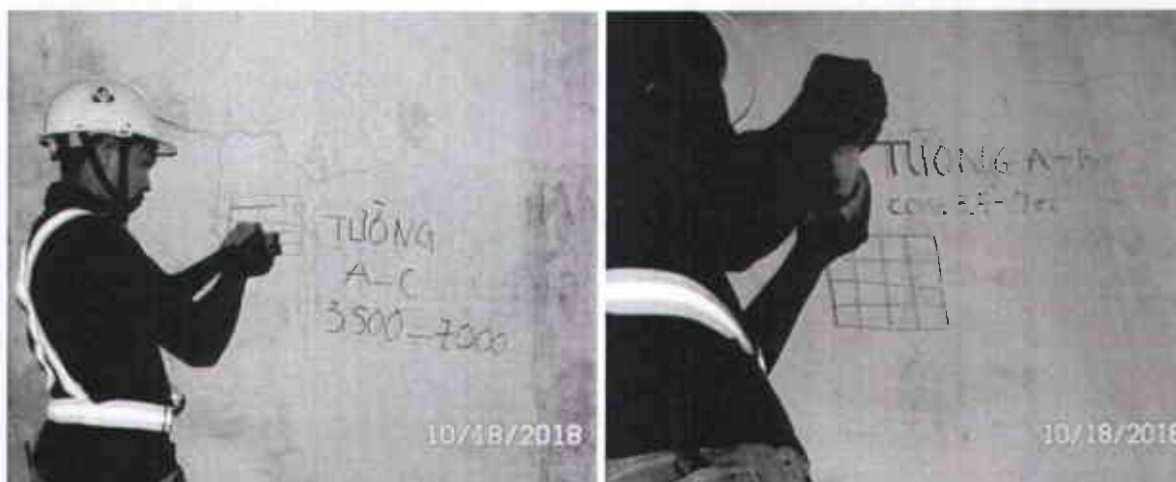
Hình 4.18 - Công tác kiểm tra cường độ tường dùng thiết bị bật nảy
